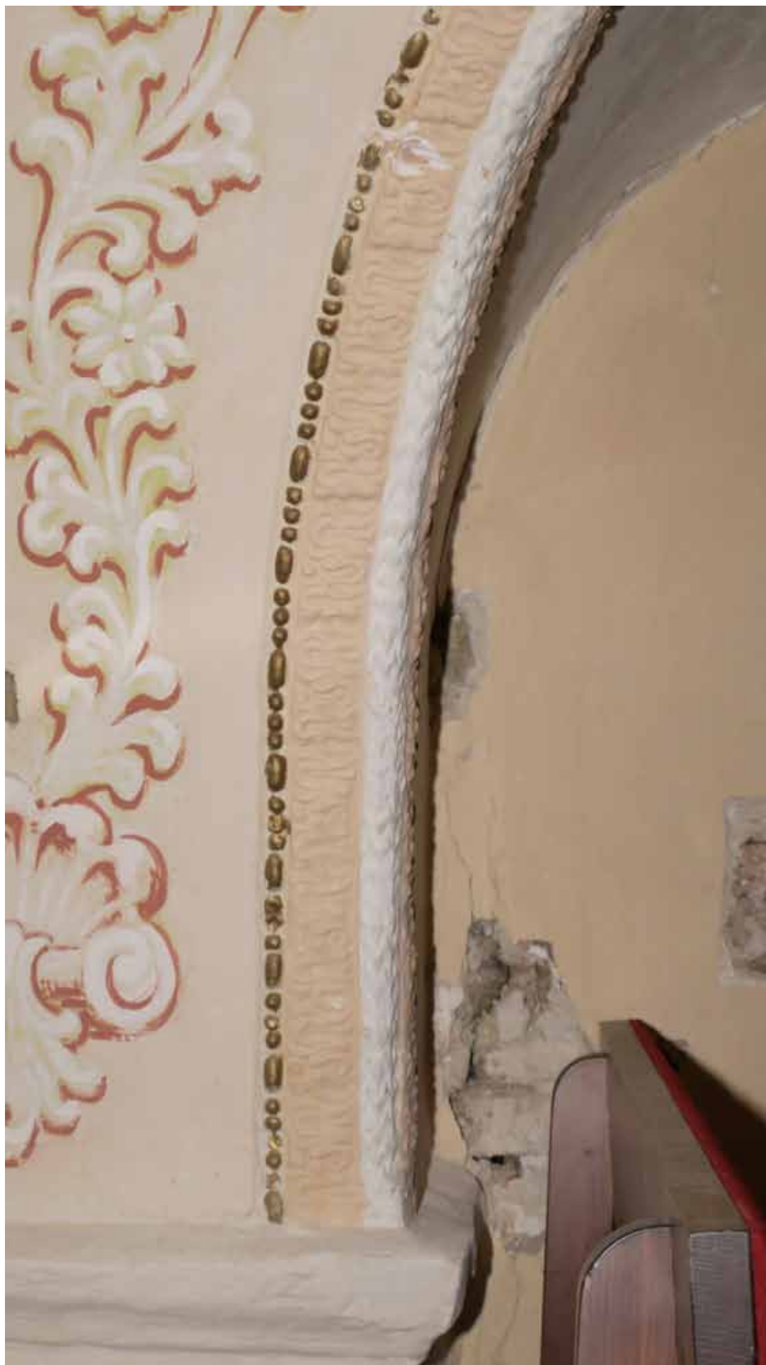
Deformácia modelácie štukovej výzdoby výsečí klenby lode kostola
