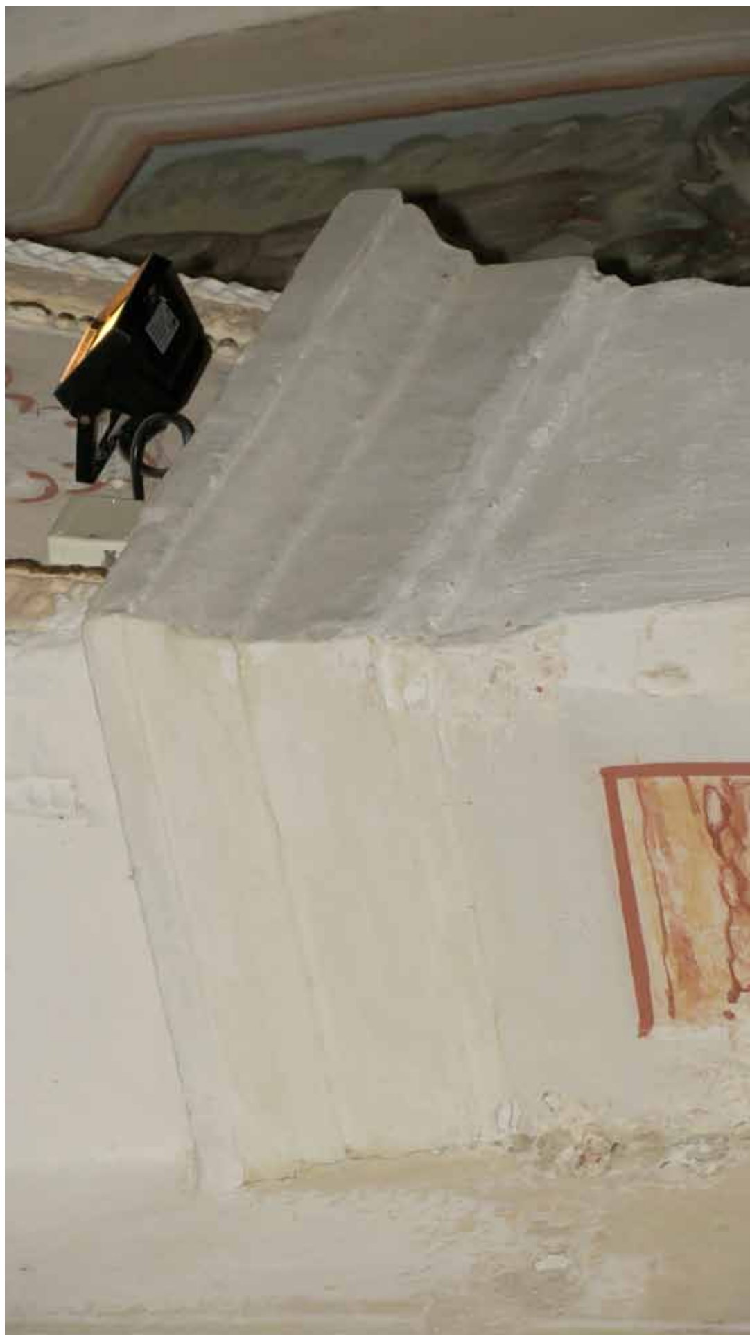
Deformácia modelácie hlavice pilastra v lodi kostola
