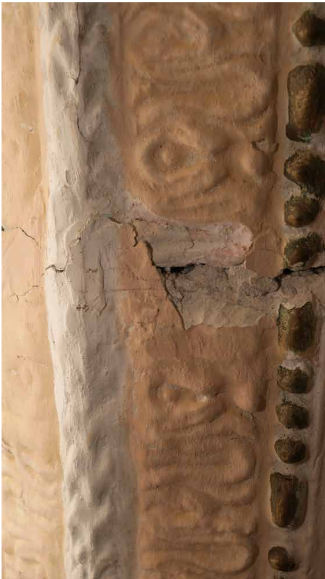
Deformácia modelácie a poškodenia štukovej výzdoby výsečí klenby lode kostola /detail/
