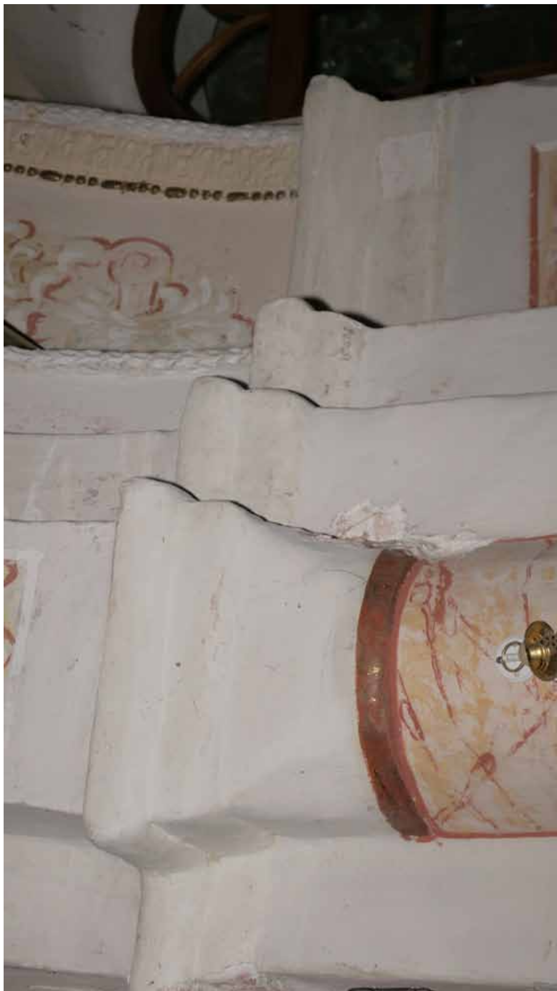
Deformácia modelácie a poškodenia štukovej hlavice stĺpa víťazného oblúka /detail/
