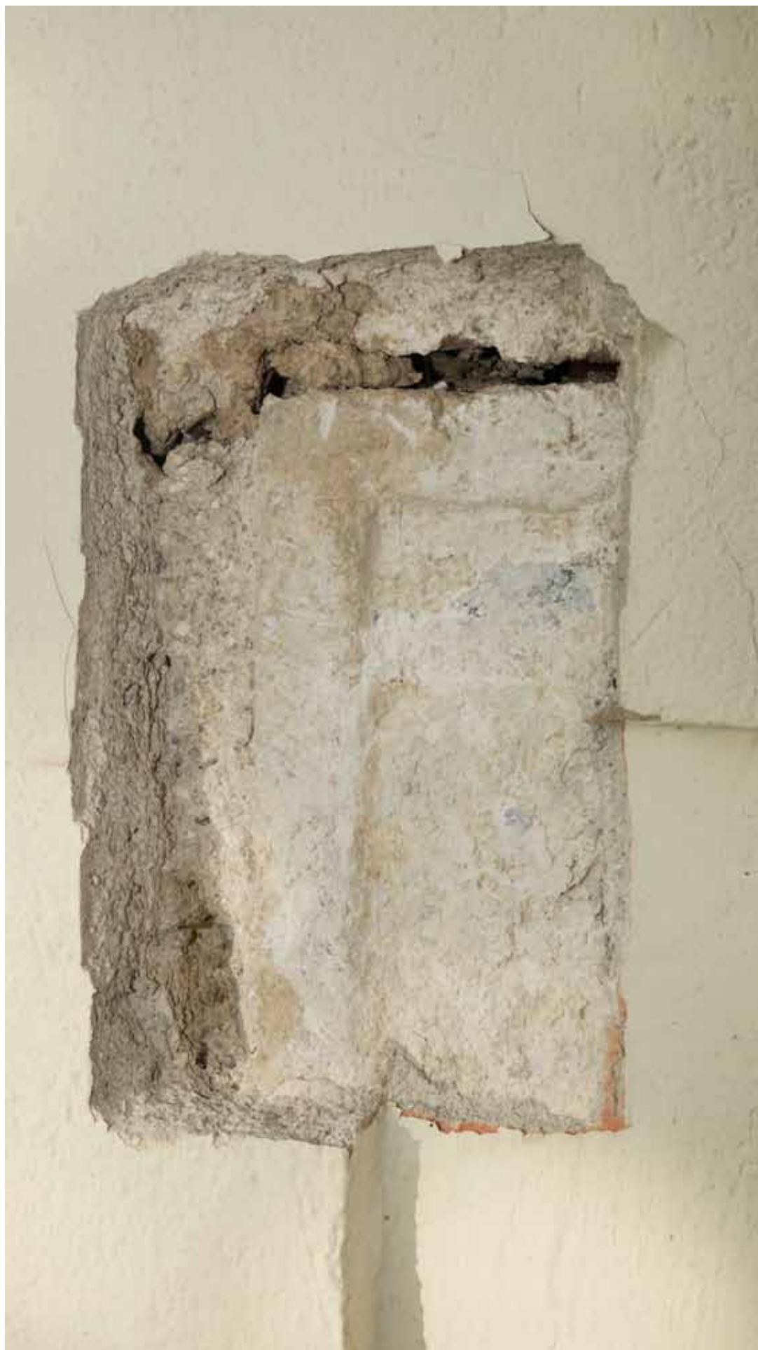
Detail stavu kamennej hmoty prvkov portálu západného vstupu do podvežia
