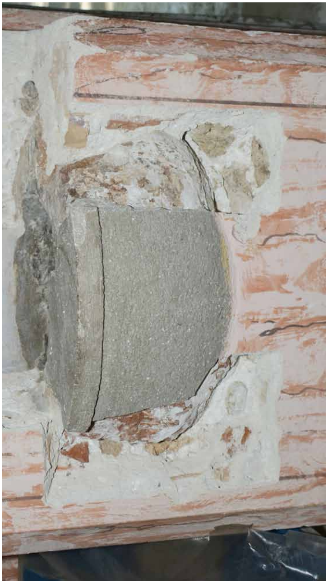
Svätenička v pilastri na južnej stene lode kostola - novotvar zo silne cementovej hmoty
