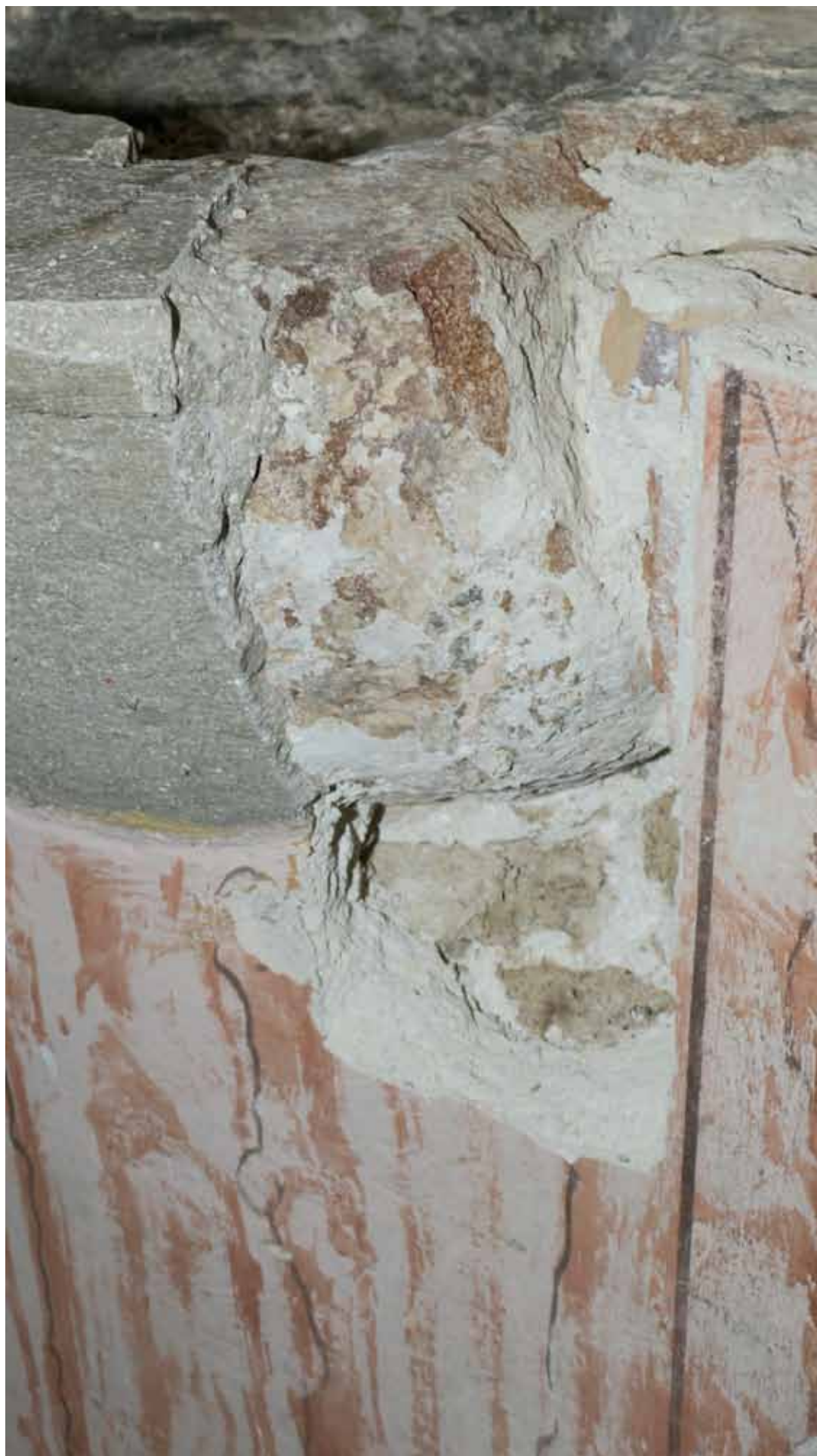
Svätnička v pilastri na južnej stene lode kostola - v sonde silne deštruovaná pôvodná kamenná hmota
