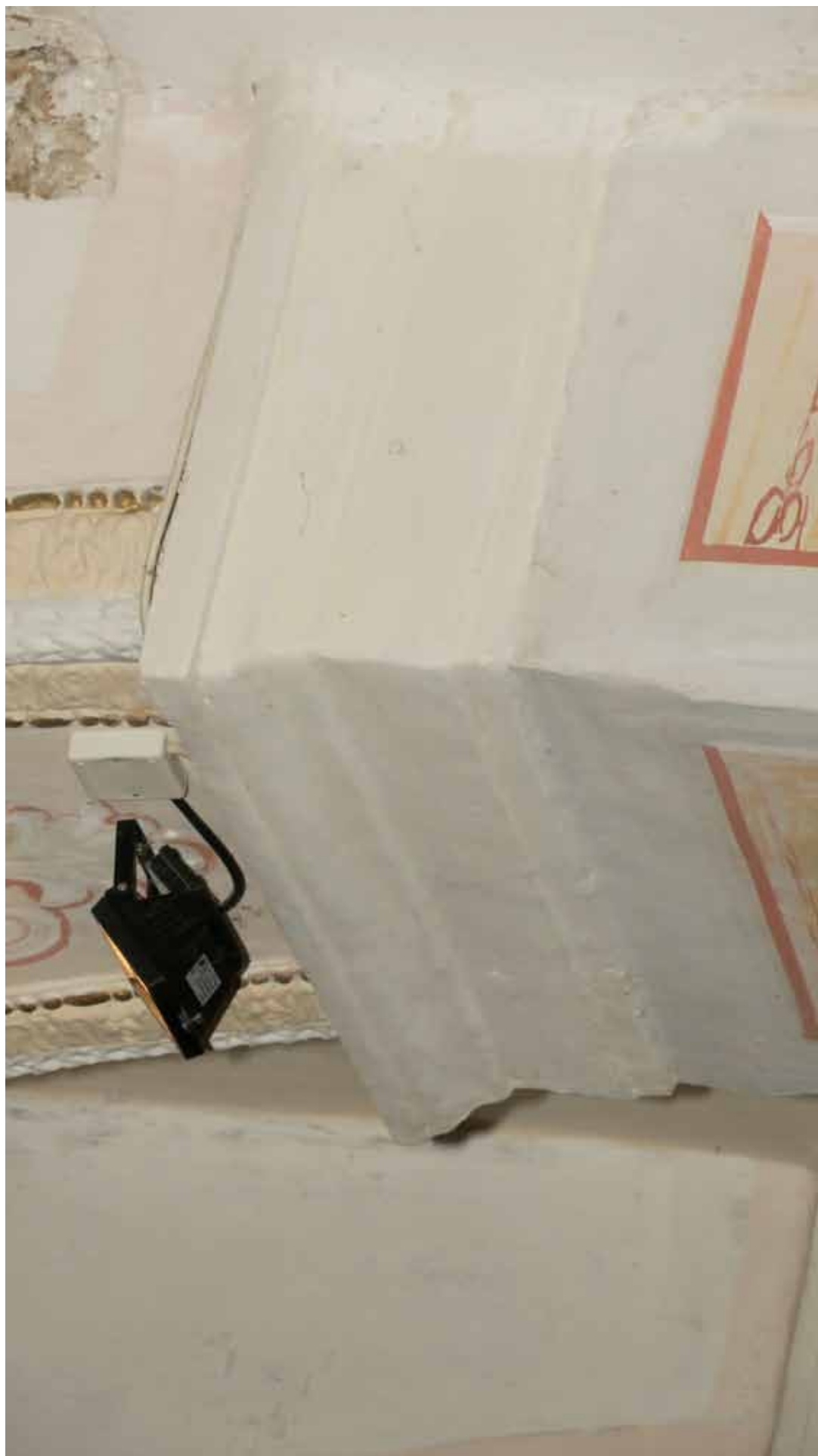
Deformácia modelácie hlavice pilastra v lodi kostola
