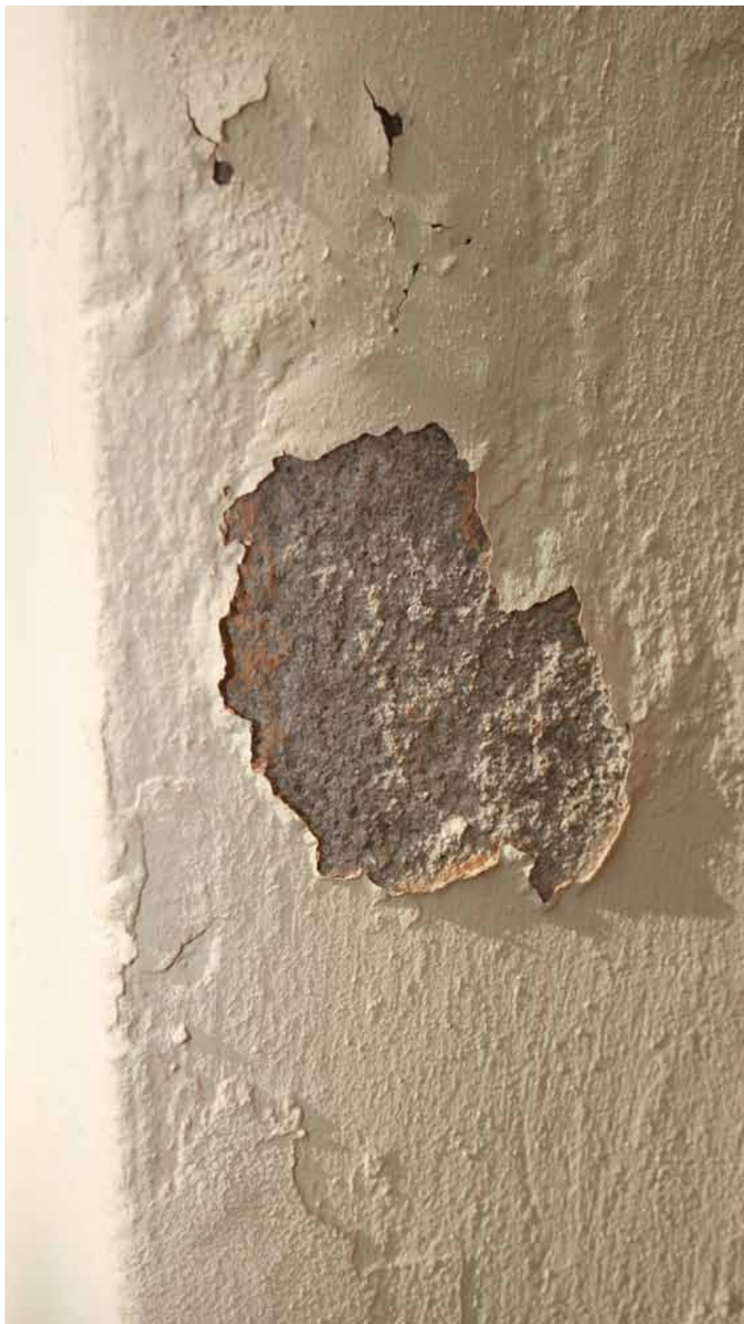
Vplyv vzliňajúcej vlhkosti a solí na hmotu kameňa prvkov portálu západného vstupu do podvežia /detail /
