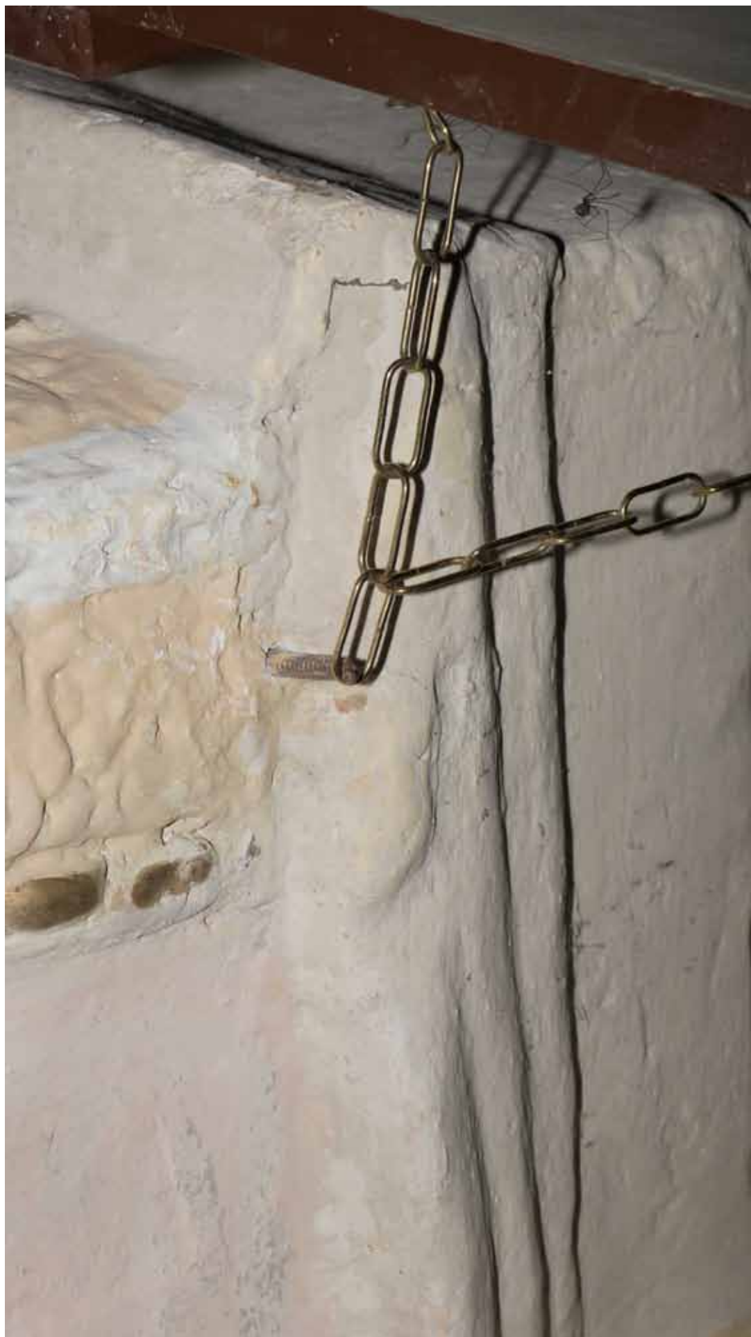
Deformácia modelácie a poškodenia štukovej hlavice pilastra /detail/
