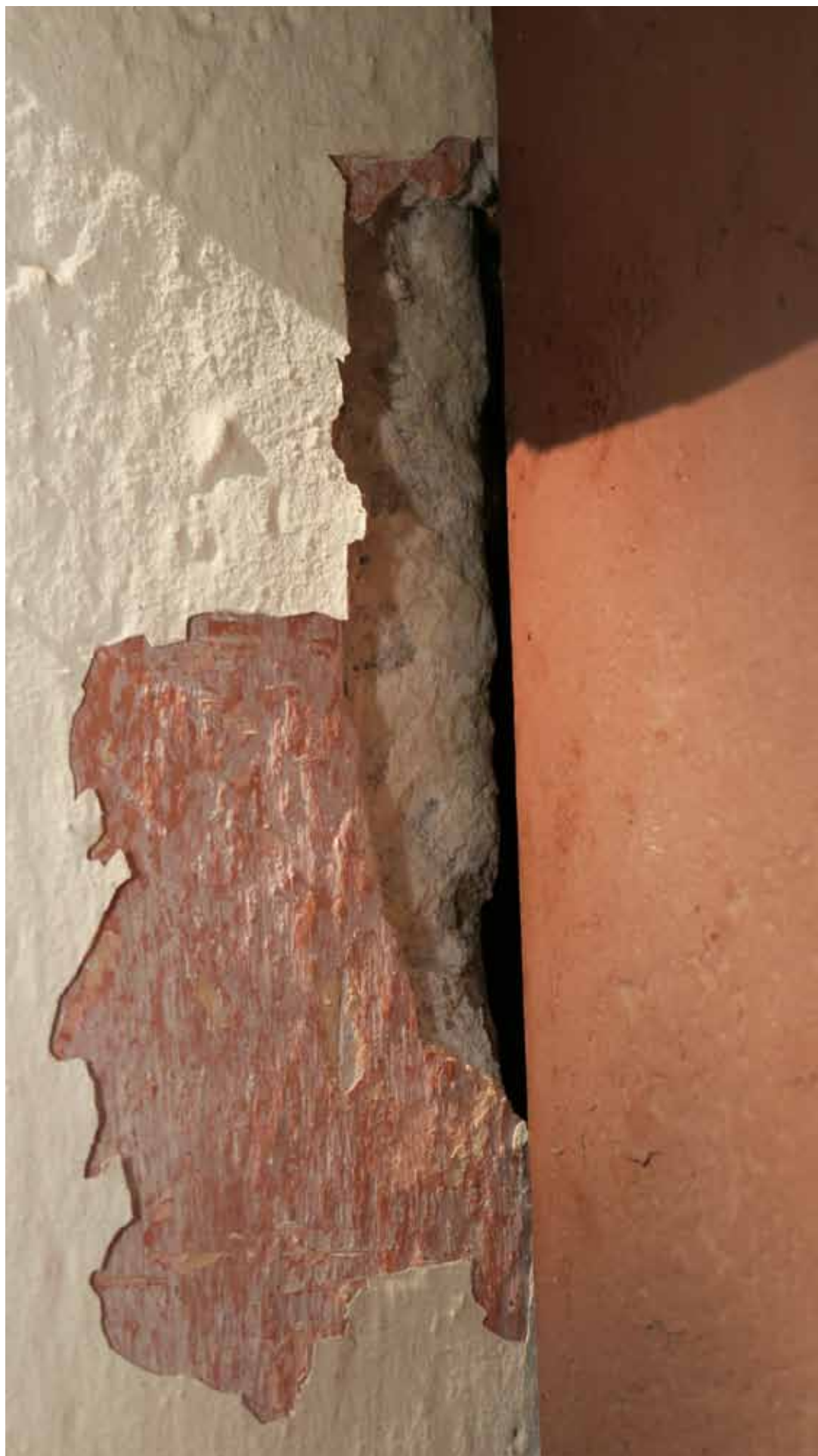
V sonde odkryté cementové vrstvy s červeným náterom z prvej polovice 20.storočia /detail /
