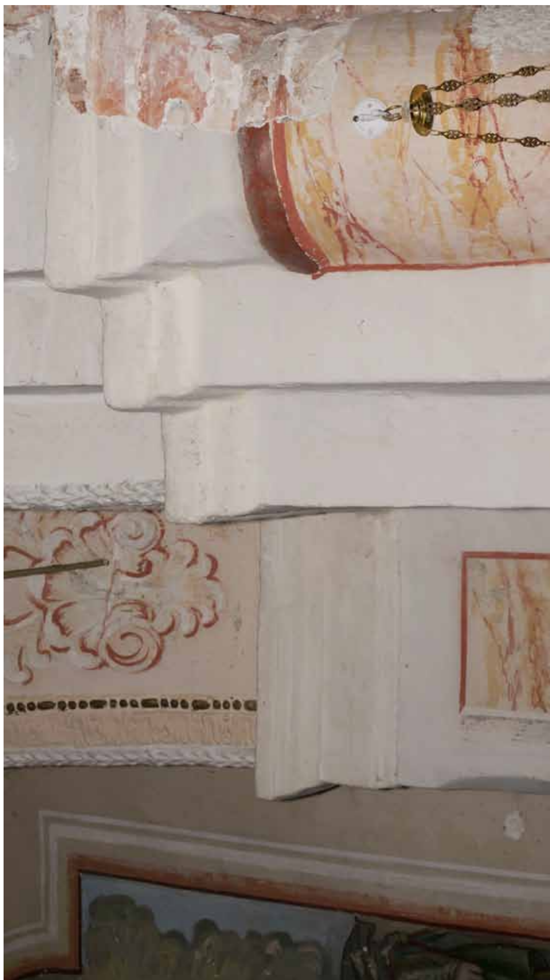
Deformácia modelácie a poškodenia štukovej hlavice pôvodne prípory víťazného oblúka / v ľavej časti v sonde pôvodná farebnosť ešte pred zosekaním drieku stĺpa /
