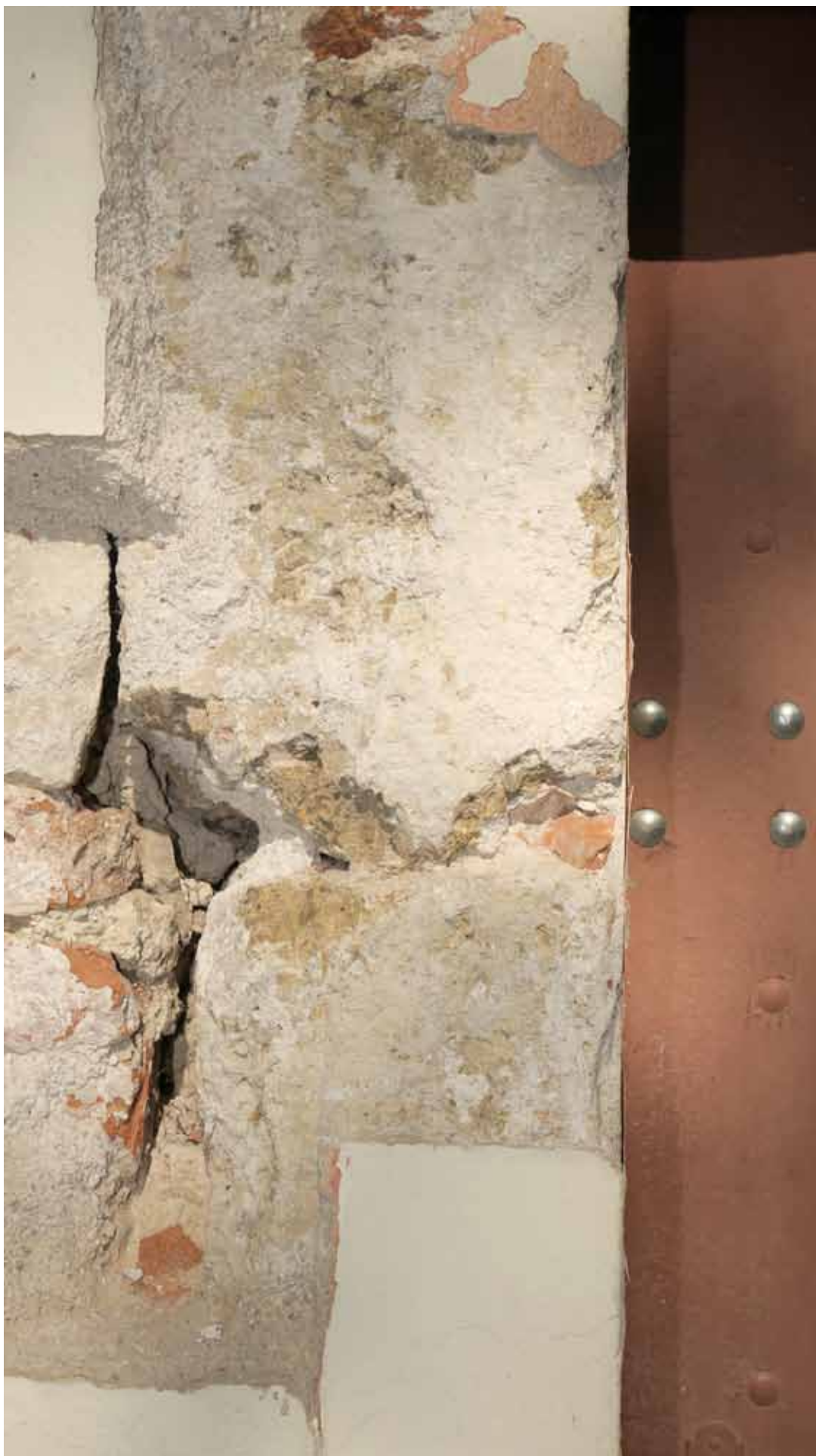
Detaili stavu kamennej hmoty prvkov portálu západného vstupu do podvežia
