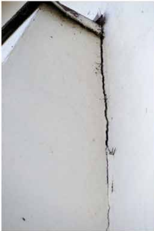
obr.18 detail z obr.17 odklon dodatočného operáku
