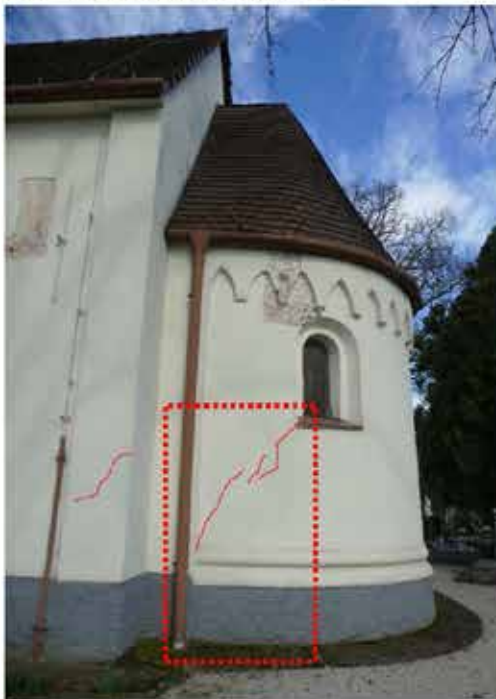
obr.02 trhliny signalizujúce nerovnomerný pokles východného ukončenia apsidy
